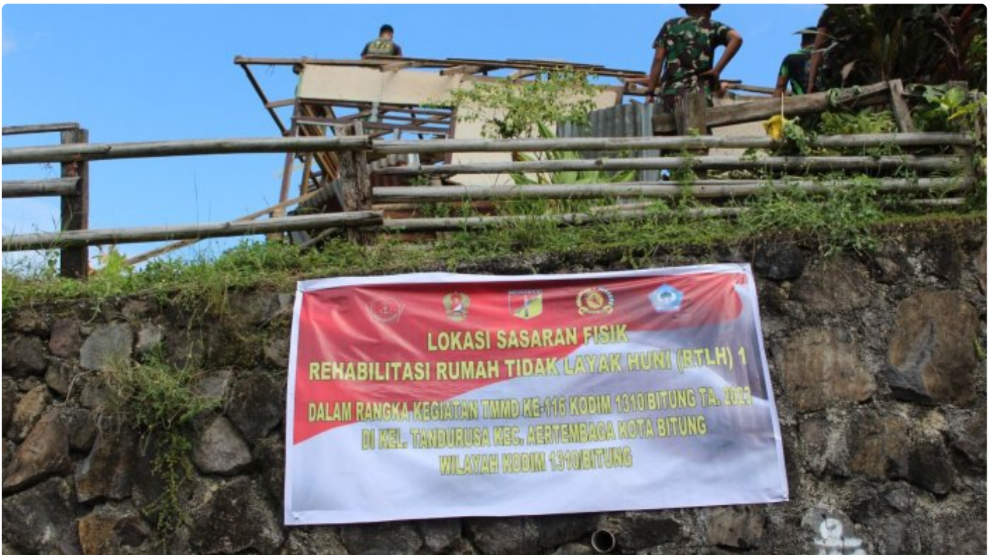
Kegiatan Pembangunan Rumah Tidak Layak Huni (RTLH) oleh Satgas TMMMD Ke-116 di Kelurahan Tandurusa
